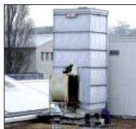
Les tours aéroréfrigérantes
