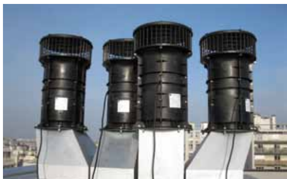
Conduits de ventilation naturelle assistée
