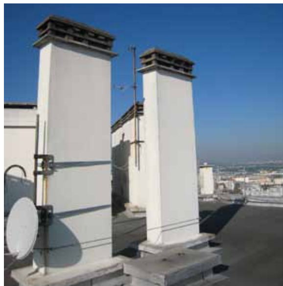
Conduits de ventilation naturelle
